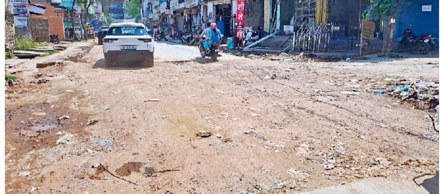
झज्जर। सड़क निर्माण के दौरान अधूरी छोड़ी गई पुलिया। फोटो: हरिभूमि
